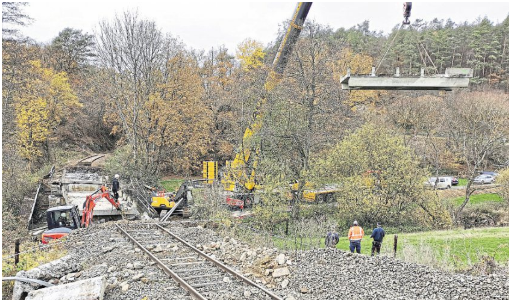
In dieser Woche fand bei Niederähren der Teilabbruch der dritten Brücke über den Holzbach statt. Etwas über 30 Tonnen Gewicht hingen am Kranhaken und konnten im großen Bogen um Bäume herum an der Baustraße abgelegt werden.
