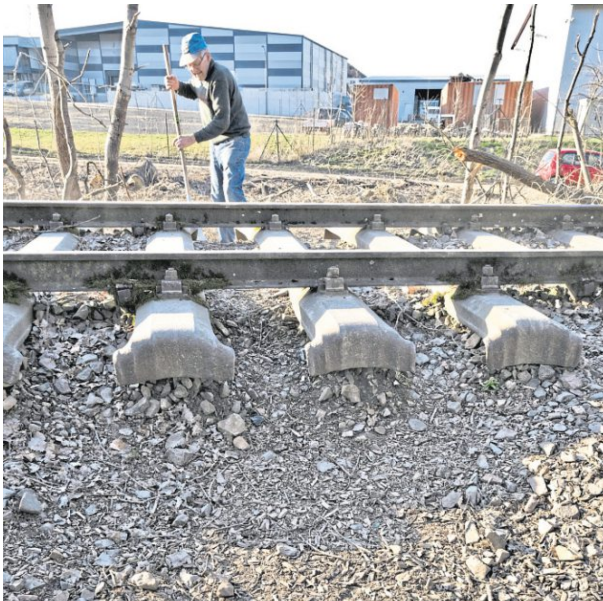
In Büchenbeuren verläuft hinter der Jahnhalle ein Rundwanderweg, der auch von Polizeistudenten vom Hahn auf ihrer Jogging-Runde genutzt wird. Hier fehlt der Schotter unterm Gleis im Bereich des Überwegs komplett. Adi Bremm räumt den Weg nach Rodungsarbeiten von Geäst und Zweigen frei.
